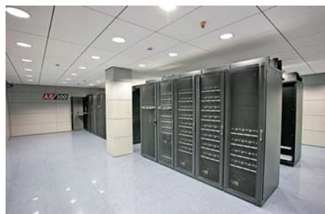
Рис. 3. Суперкомпьютерный комплекс НПО «Сатурн»
